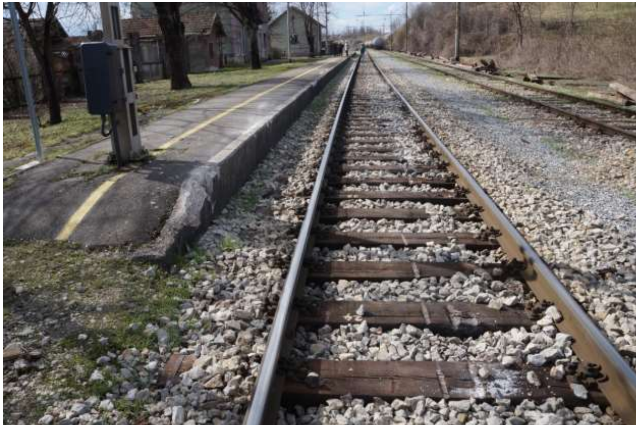
Slika 9. – Detalj tragova iskliznuća kod perona u kolodvoru Zvečaj (izvor slike: AIN)
