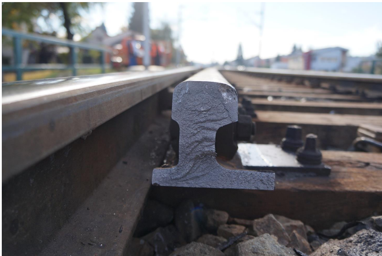
Slika 13. – Slika presjeka puknuća prijevodnice skretnice br.1 (izvor slike: AIN )
