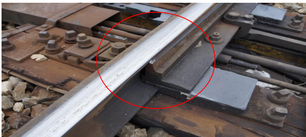
Slika 6. – Oštećena prijevodnica, Zagreb GK (Izvor slike: AIN)
