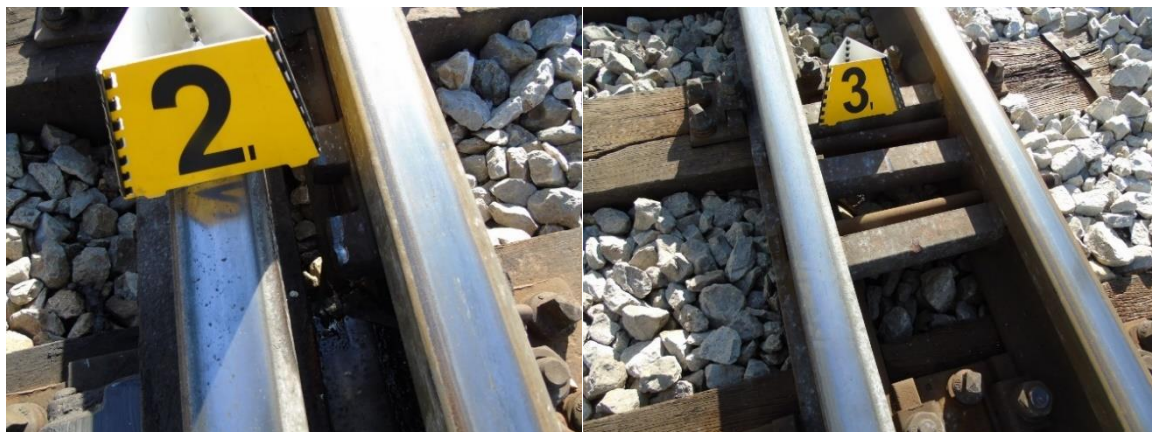
Slika 9. – Oštećenje kod skretnice broj 5 (izvor slike: AIN)
