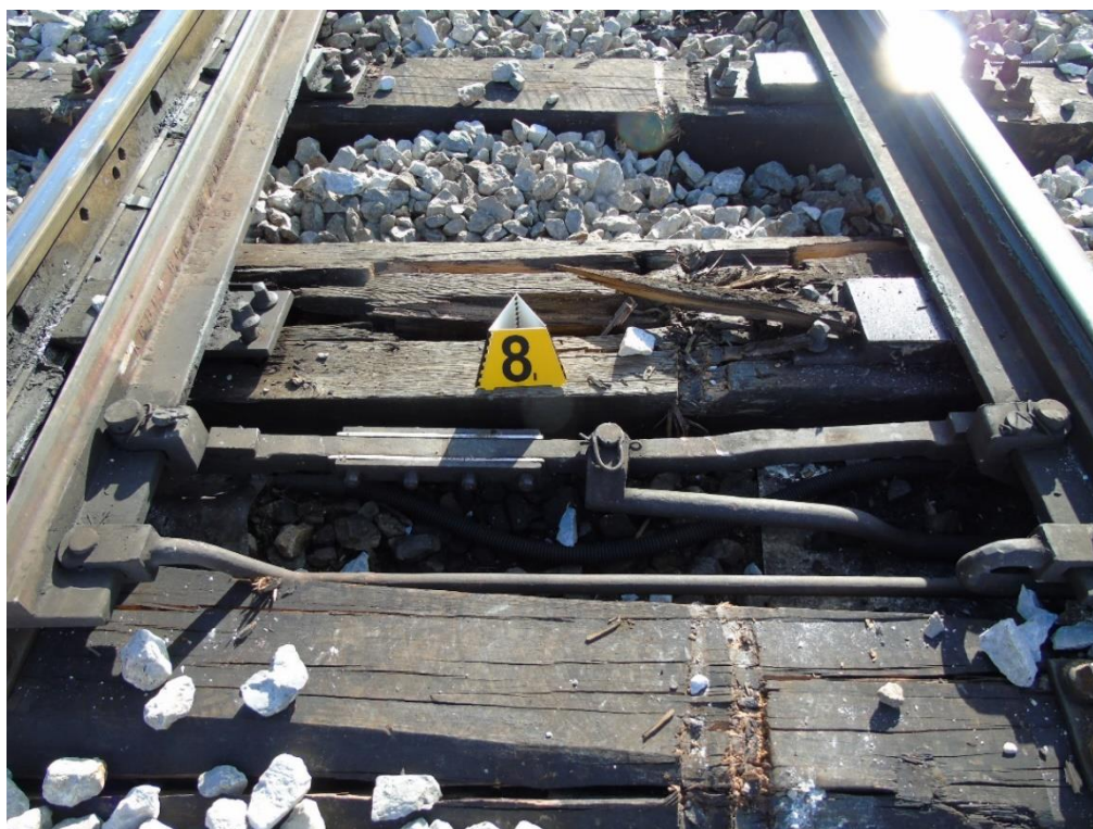
Slika 10. – Oštećenje kod skretnice broj 4 (izvor slike: AIN)
