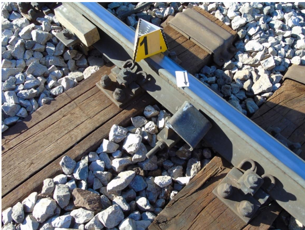
Slika 8. – Oštećen štitnik uključnog kontakta (izvor slike: AIN)
