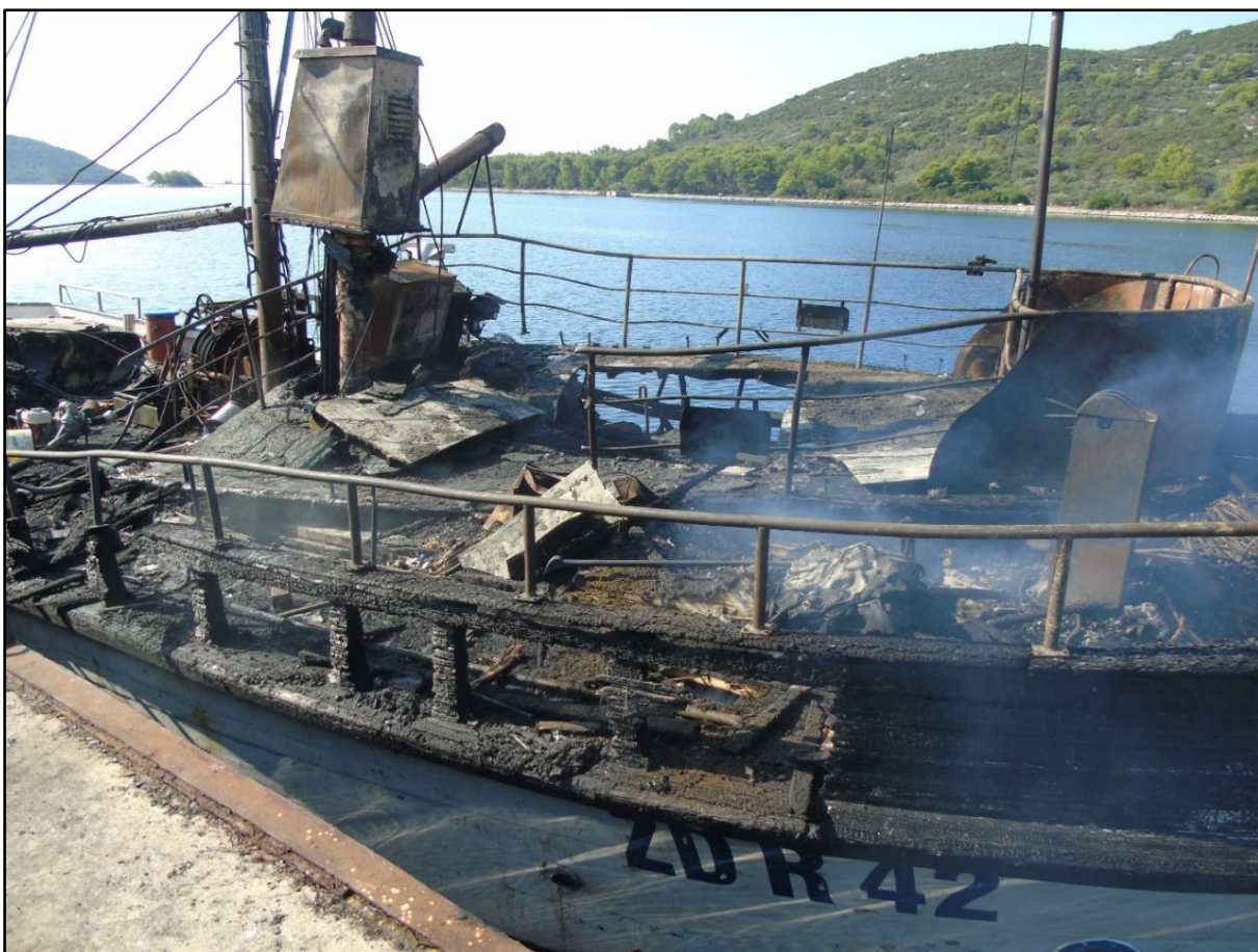
Slika 4. Urušeno nadgrađe broda „Arkaj“ nakon požara, gledano s desne strane (izvor: AIN)
