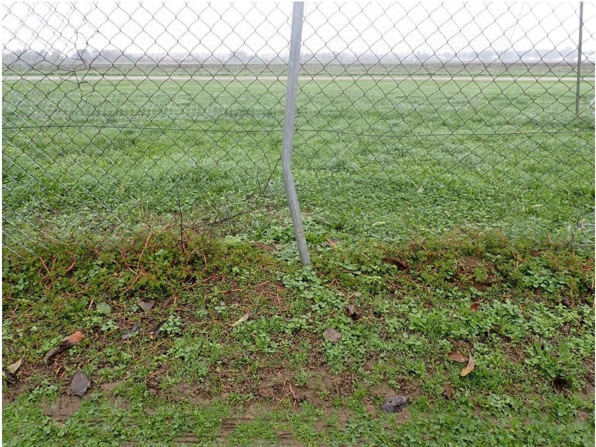
Slika 6. – Ograda oko Aerodroma Lučko i oštećenje (rupa) u njoj
