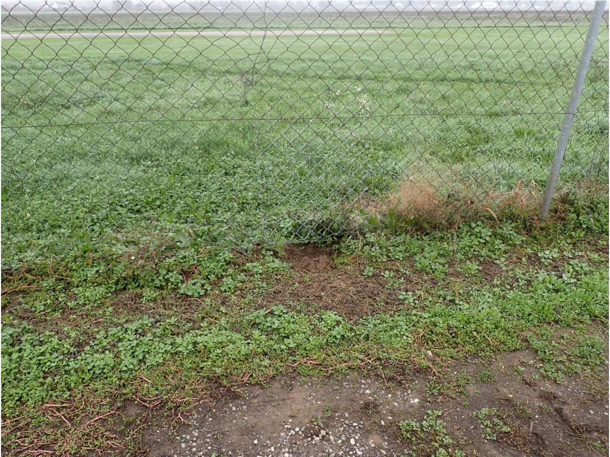
Slika 7. – Ograda oko Aerodroma Lučko i oštećenje (rupa) u njoj
