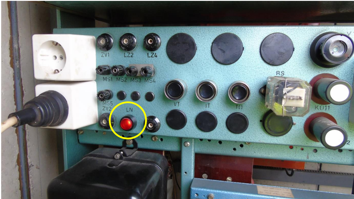
Slika 8. Kontrolna sijalica "LN" kvara uređaja (Izvor slike: AIN)
