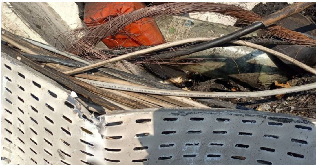
Slika 8. Trasiranje snopova kabela u jednoj metalnoj trasi (izvor:AIN)
